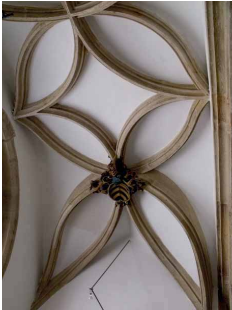
Bild 3.7.25 Brüx, Seitenschiff – Höhentoleranzausgleich Mittels oberer Rippenerhöhung im Stein
