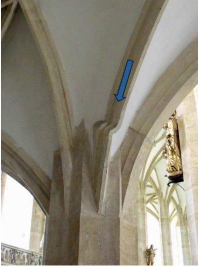
Bild 3.6.17 Brück, Mariä Himmelfahrt, Passproblem zwischen Rippenanfänger und auslaufender Rippe wurde durch kurzen Versatzkorrigiert und nicht durch Verzerrung oder längere leichte Biegung der Rippe
