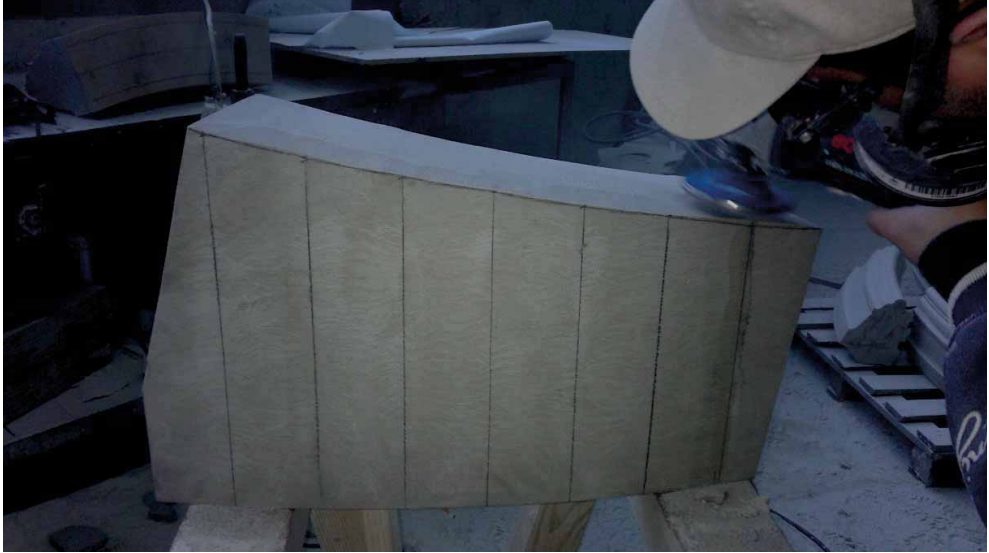
Bild 82 nach Ausarbeitung der Fugenflächen im Aufriss untere Krümmung abarbeiten und Schleifen (für Genauigkeit Reißen)
