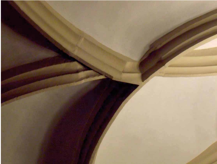
Bild 2.4.20 Ratssaal Bunzlau, nicht gekonnte Detailsausbildung statt einer sich anlegenden Rippe wird diese in sehr grobschlächziger Anpassung in die Rippenkreuzung des Blütensterns eingebunden
