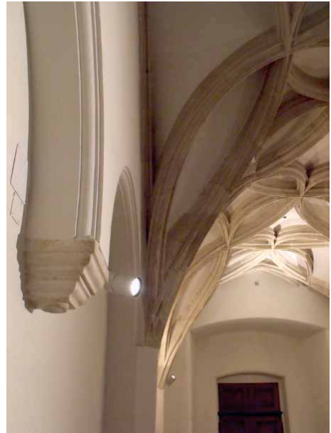
Bild 3.7.26 Wien, Landhauskapelle – oberseitige Rippen-erhöhung in auslaufender Rippe (Anfänger)
