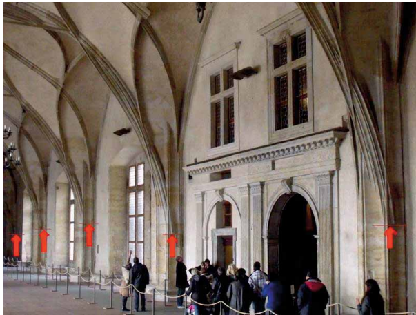
Bild 3.6.6 Prag – Wladislawsaal, die Gewölbeanfänger an den Jochgrenzen befinden sich in erheblich unterschiedlichen Höhen mit bis zu ca. 40cm Unterschied über die Saallänge, bei fallendem Prinzipalbogen (vgl. C.A.Meckel) ist dies die Toleranzaustragung aus der gesamten Figuration, d.h. alle Scheitelpunkte sind gleich hoch und die Toleranzen aus unterschiedlichen Raumbreiten/-längen – was zu unterschiedlichen Kurvenlängen führt – werden über unterschiedlich hohe Gewölbeanfänger abgetragen und wie selbstverständlich zur Konstruktion gehörend offen gezeigt
