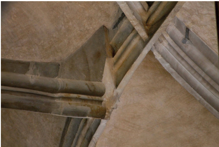
Bild 2.4.21 Wladislawsaal Prag, Detail Rippenanbindung der sich anlegenden Rippe, konstruktiv über – von unten nicht sichtbaren – Blockstein ausgebildet
