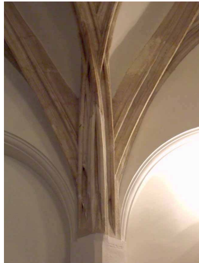
Bild 3.6.10 Wien-Landhauskapelle, Rippenanfänger links liegt nur geringfügig von Rippenanfänger rechts in der Höhenlage
