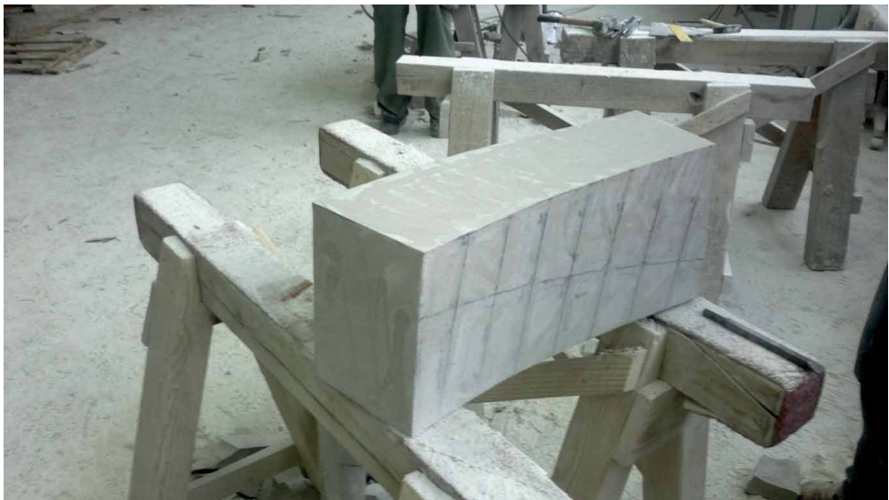
Bild 81 Reißen Fugenfläche im Aufriss
