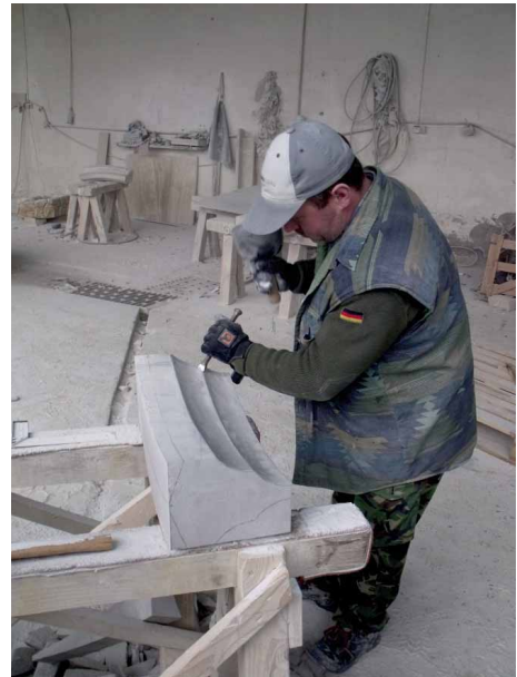
Bild 86 Ausarbeitung der Kehlungen mit beginnendem Randschlag und danach sphärisch gekrümmte Kehlfläche freihändig
