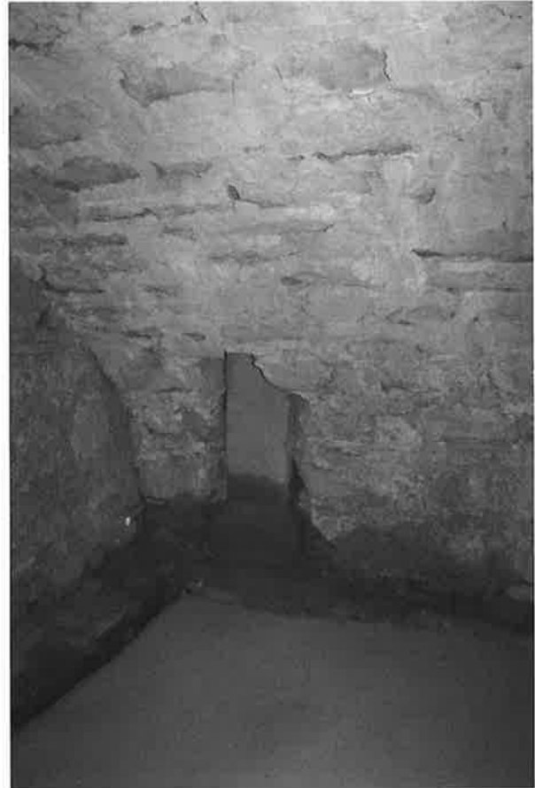
Abb. 5: Abdrücke der flächigen Lehrschalung der Mörtelausgleichsschicht der Steinwölbung aus Bruchsteinen, Schloss Dresden um 1470 (Foto: bauer lauterbach Archiv).
