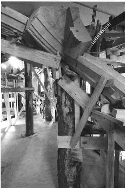
Abb. 9: Schritt 2, Versatz der Werksteinrippen zwischen den Knoten – freihändig – mit Holzteilen ausgerichtet zur Toleranzaufnahme (Foto: Rainer Böhme)
