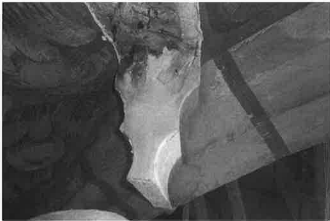
Abb. 7: Befunde Rippenversatz St. Peter und Paul in Melnik Ende 15. Jh. mit Holzkeilen in den Rippenfugen; Bild aus Aufsatz D. Sterbova, „Připravne ryte konstrukce na kamenném zdivu“, Sborník 12-2014 (dort Bild Nr. 11 mit Hinweis auf J. Rafl, 2010)
