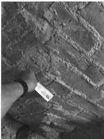
Abb. 13: Rissbefund Oberseite Wölbjoch in Mitte zwischen jeweils am Wölbanfänger senkrecht aufgemauerten Anfängerrippen (Foto: bauer lauterbach Archiv).
