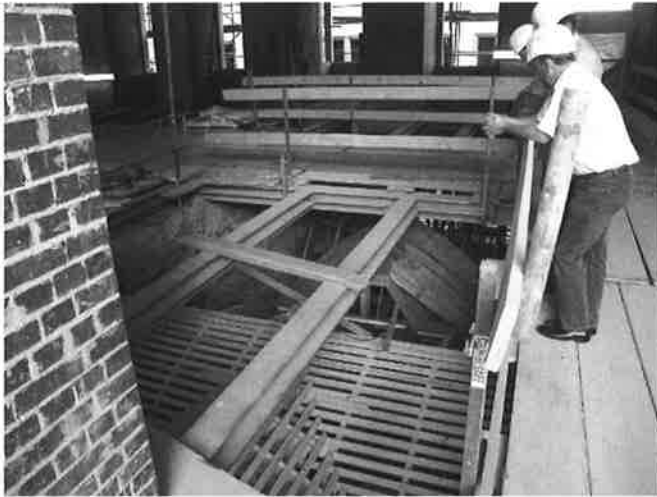
Abb. 6: Lehrgerüst Flächenrost-Rekonstruktion 2006 der Gotischen Halle von 1468 im Schloss Dresden (Foto: bauer lauterbach Archiv).
