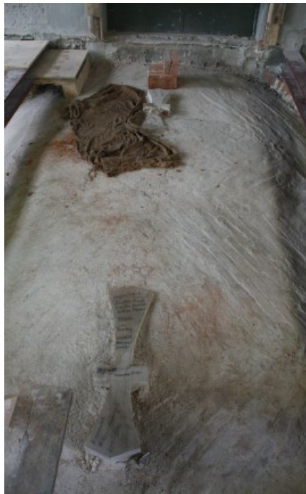
Bild 5. Oberseite eines Gewölbejoches mit dünnem Kalkschlämmputz im Bereich Scheitelfiguration zur Ziegelschlusssteinsetzung (hier unter Jutebahn zur direkten Nachbefeuchtung) (Foto: Gert Schubert)
