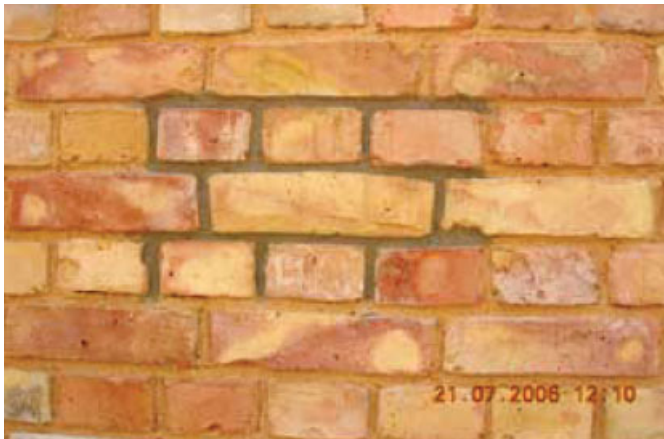
Bild 22. Muster Fugenmörtel Hinter dem Gießhaus Berlin Fig. 22. Jointing mortar samples behind the Giesshaus Berlin
