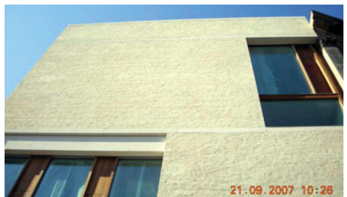
Bild 34. Fassade im Streiflicht Hinter dem Gießhaus Berlin Fig. 34. Façade in oblique lighting behind the Giesshaus Berlin
