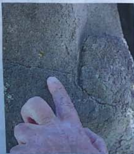
Unterhalb der Brücke sind Brüche im Gestein erkennbar.
